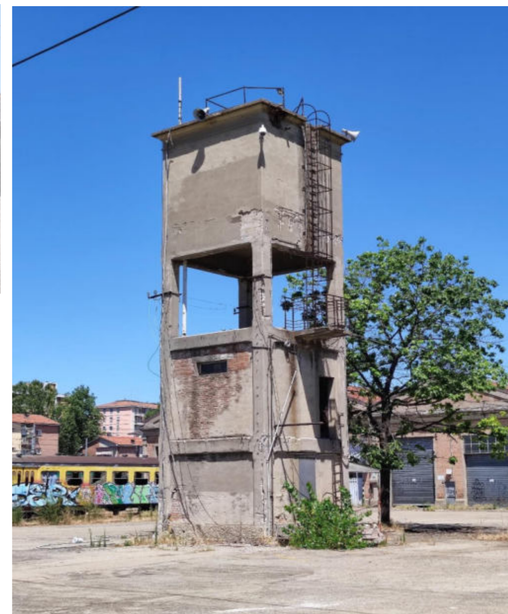
10 – Torre piezometrica, foglio 175, part. 201
