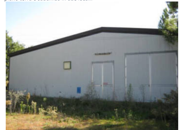
Figura 39. Fabbricato D - capannone zootecnico. Costruzione con struttura portante in acciaio, costituita da pilastri e travi reticolari con arcarecci di copertura, il tutto opportunamente coibentato e tutt'ora in buono stato di conservazione, per una superficie lorda complessiva di circa 1.680,00 mq
