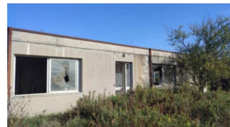
Figura 6. Ex SIVALCO Fonte: Regione Emilia – Romagna sopralluogo 2023
