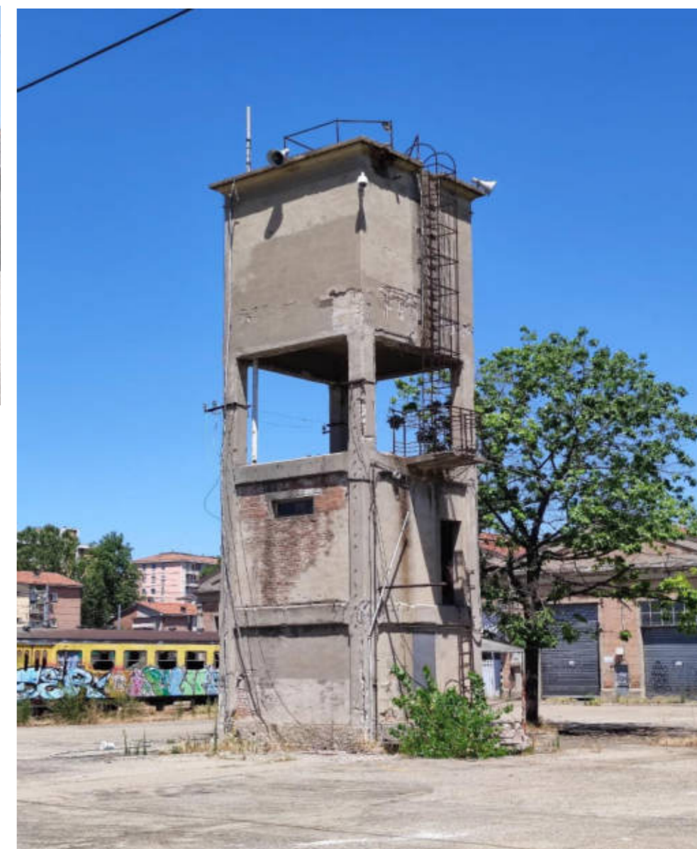
10 – Torre piezometrica, foglio 175, part. 201
