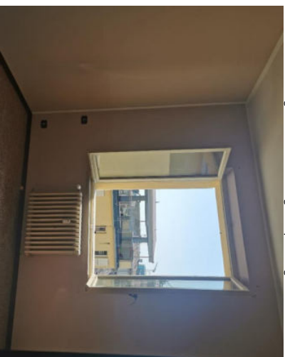
Figura 3. Foto Fonte: Regione Emilia-Romagna sopralluogo 2021 - Sub13
