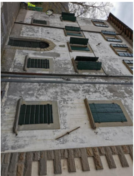
Figura 13. Foto Fonte: Regione Emilia-Romagna sopralluogo 2021
