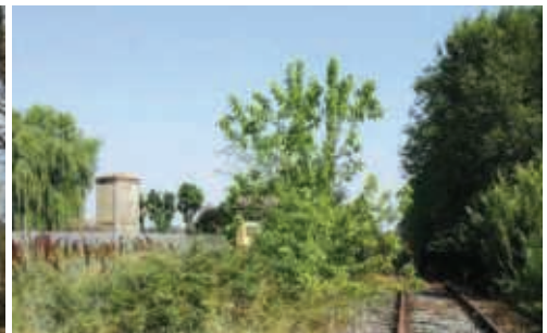
2 - Foto fabbricato collabente direzione Bondeno
