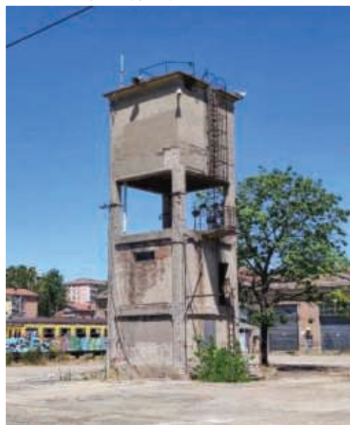
10 – Torre piezometrica, foglio 175, part. 201
