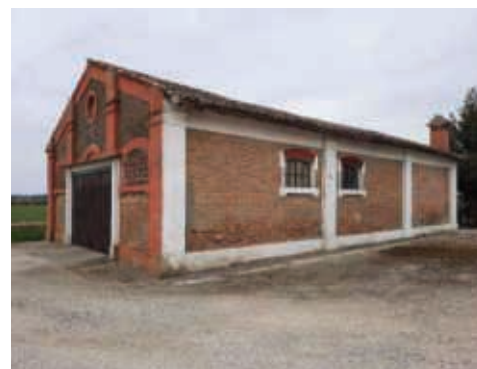
4 - Foto Fonte: Regione Emilia-Romagna – sopralluogo 2022
