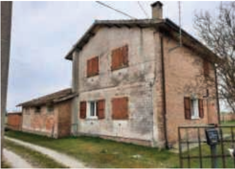
3 - Foto Fonte: Regione Emilia-Romagna – Sopralluogo 2022
