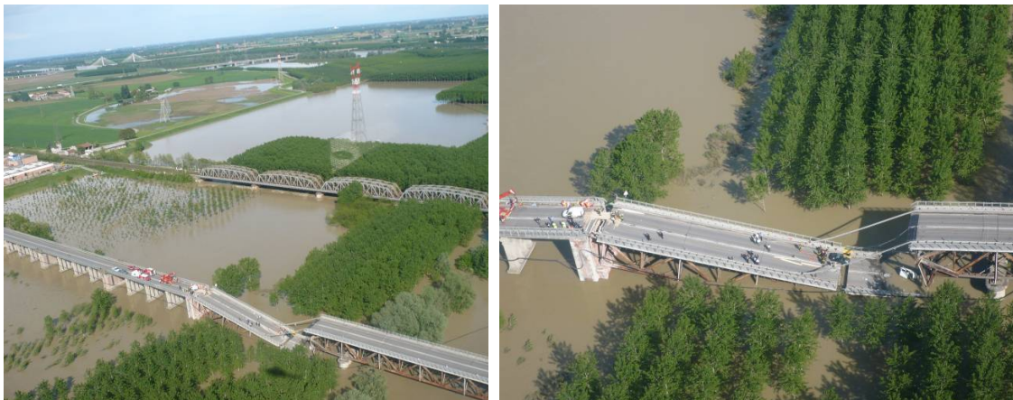
Figura 4. Cedimento di una porzione del ponte che attraversa il Po lungo la SS9 Emilia avvenuto il 30 Aprile 2009.
