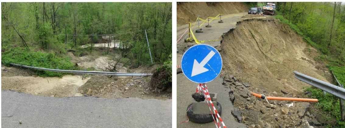
Fig. 11. S.C. della Regola (comune di Piozzano), interessata da un esteso dissesto.
