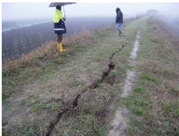
Fig18: Argine del Fiume Santerno con evidenti fenditure longitudinali
