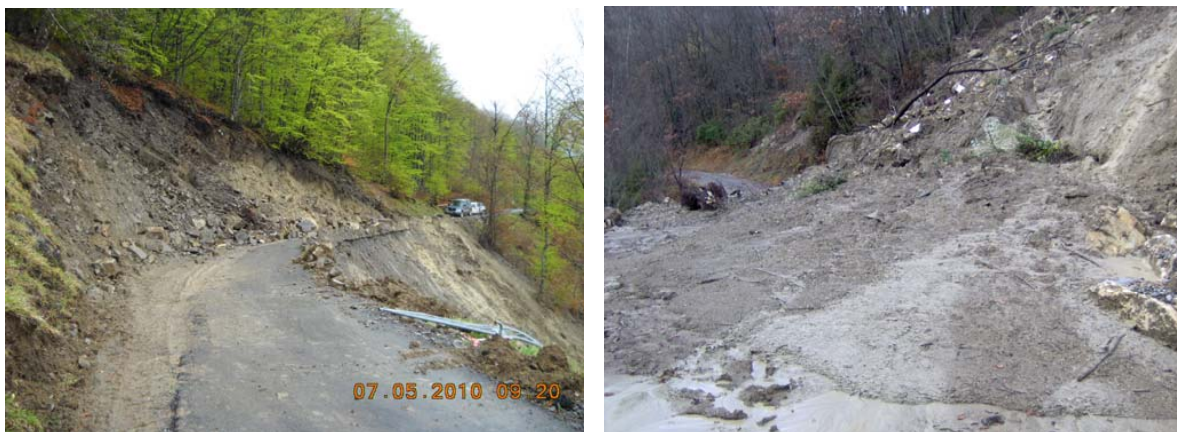
Fig 12: a sinistra la frana che ha interessato la strada comunale Pizzonero-Suzzi (comune di Ottone); a destra la frana che ha interessato la strada Rampa-Scagli (comune di Coli)
