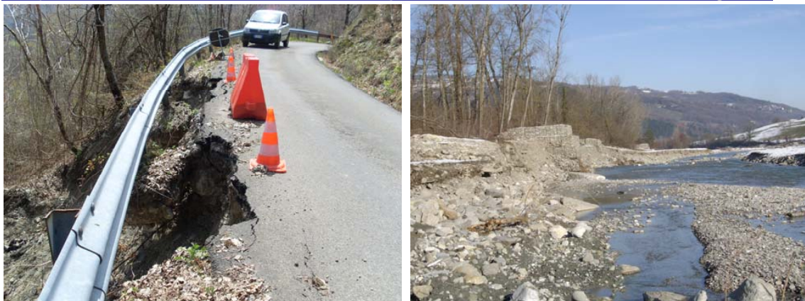
Fig13: a sinistra la frana che ha interessato la strada comunale di Ticchiano (comune di Monchio delle Corti); a destra erosione ed iniziale scalzamento di repellenti sul fiume Parma nel comune di Corniglio
