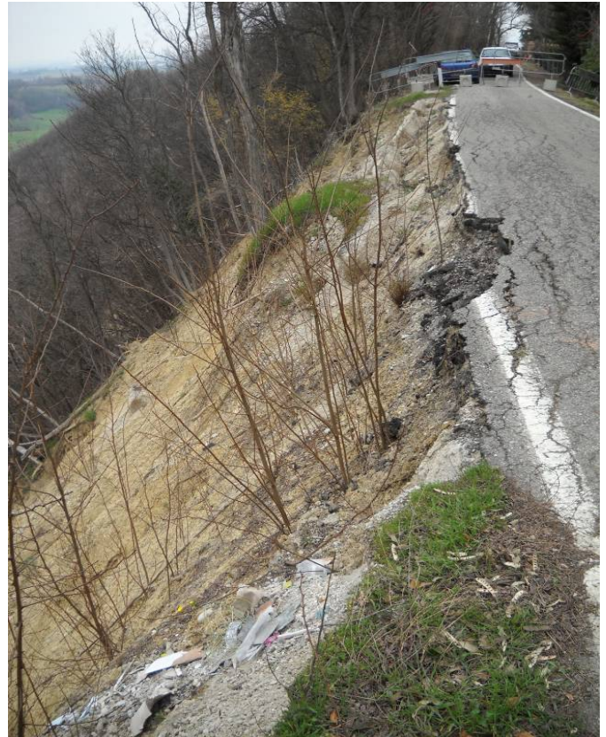
Figura 12. strada comunale chiusa per un dissesto in località Piane Casanova comune di Bardi (a sinistra). Strada comunale interrotta da un esteso dissesto in località Cogolonchio comune di Fidenza (a destra).
