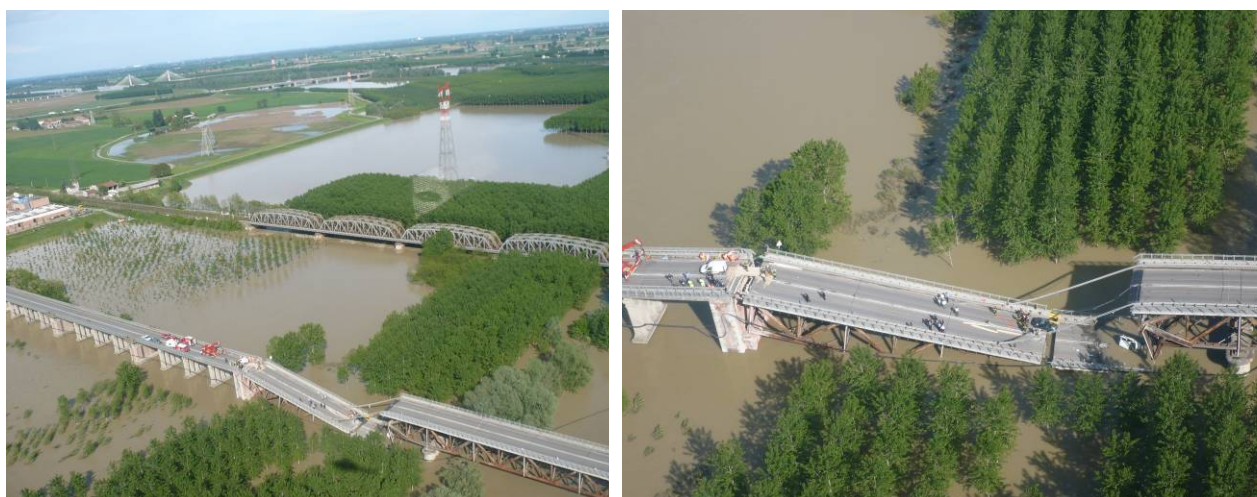
Figura 4. Cedimento di una porzione del ponte che attraversa il Po lungo la SS9 Emilia avvenuto il 30 Aprile 2009.
