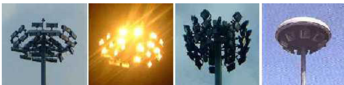
Fig.17 - Torri faro "palesemente" inquinanti. Nell'ultimo impianto a destra infatti, il cappello ha l'unico obiettivo di proteggere gli apparecchi d'illuminazione dalle intemperie. [[Immagine fornita da CieloBuio]
