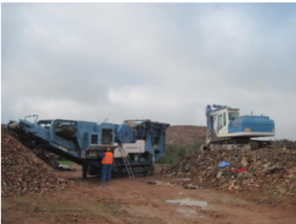
Foto 8.6 – L’impianto mobile in funzione
