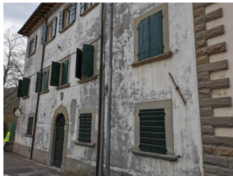
Figura 11. Foto Fonte: Regione Emilia-Romagna sopralluogo 2021
