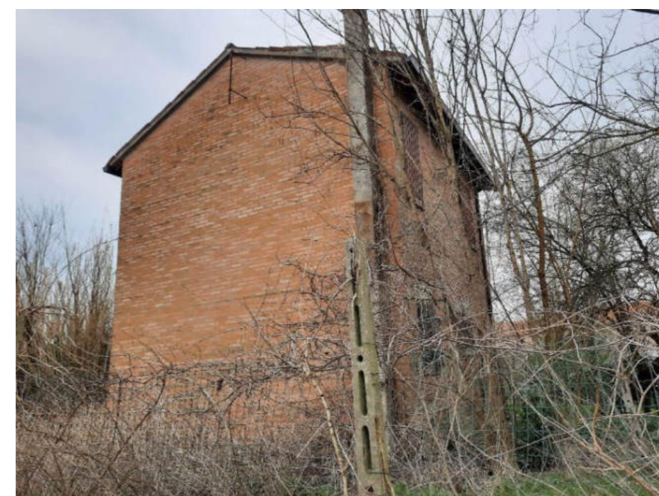
Figura 6. Foto Fonte: Regione Emilia-Romagna – sopralluogo 2022
