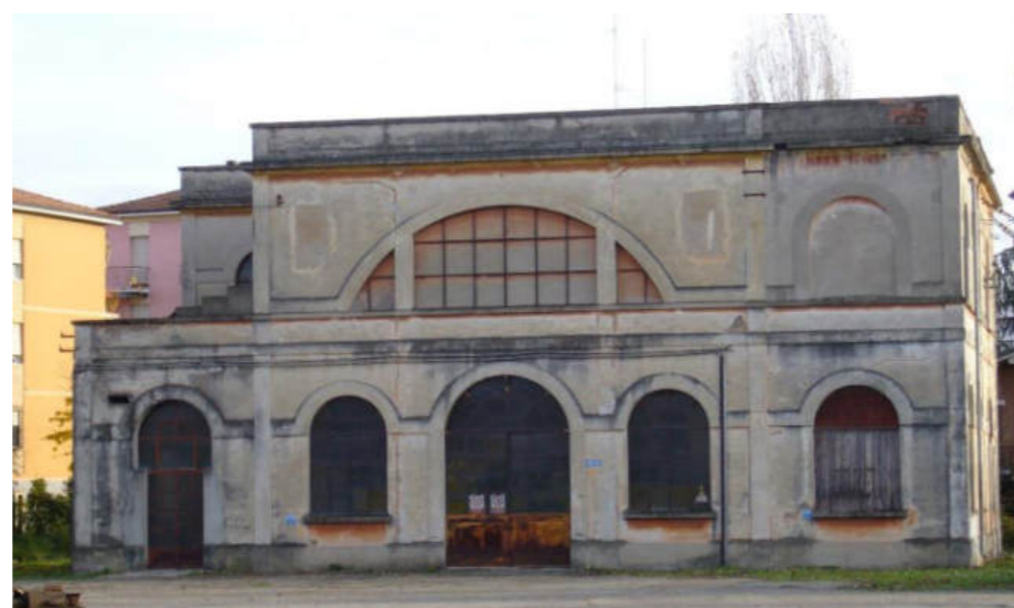
Figura 10 – Sottostazione elettrica (SSE), foglio 175, part. 205
