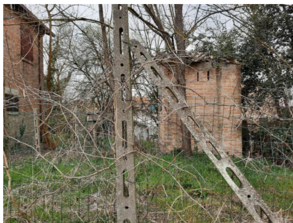
Figura 5. Foto Fonte: Regione Emilia-Romagna -sopralluogo 2022
