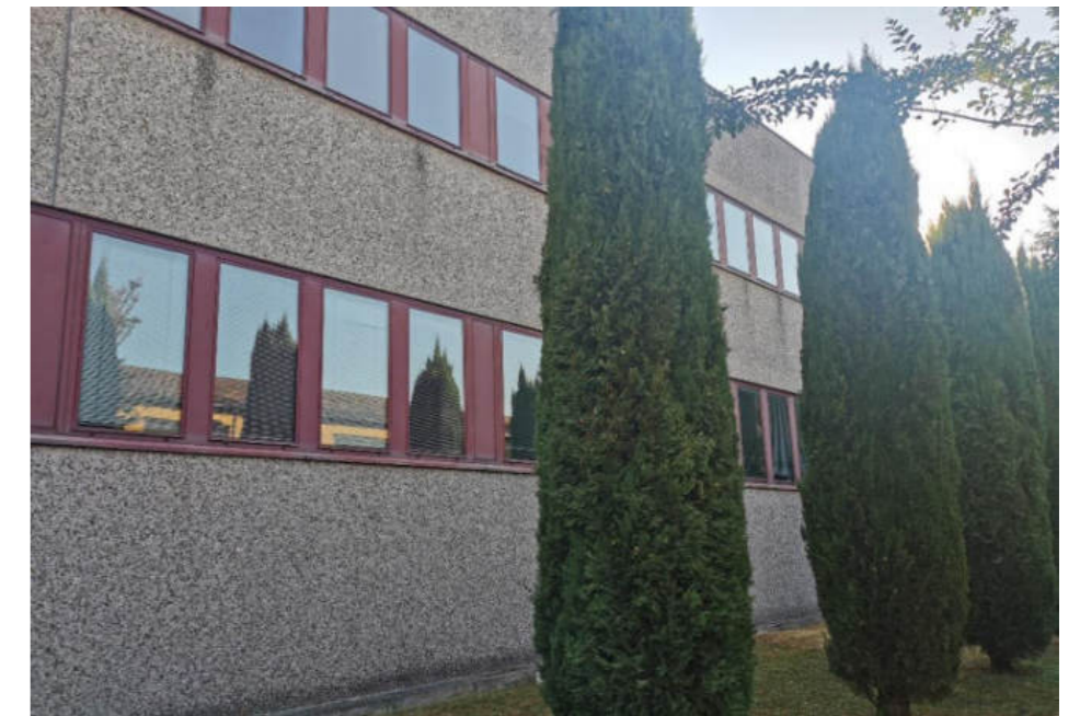
Figura 10. Foto Fonte: Regione Emilia-Romagna sopralluogo 2022
