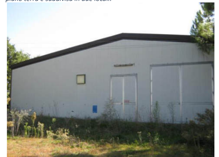
Figura 43. Fabbricato D - capannone zootecnico. Costruzione con struttura portante in acciaio, costituita da pilastri e travi reticolari con arcarecci di copertura, il tutto opportunamente coibentato e tutt'ora in buono stato di conservazione, per una superficie lorda complessiva di circa 1.680,00 mq
