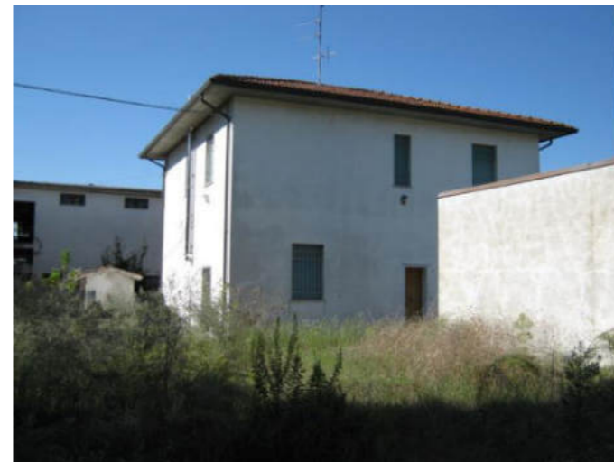
Figura 39. Fabbricato A - palazzina uffici e abitazione del custode. Edificio in muratura e cemento armato originariamente costituito dal solo piano terra, poi oggetto di un intervento di sopraelevazione che ne ha determinato l'attuale consistenza di circa 98,00 mq a piano.
