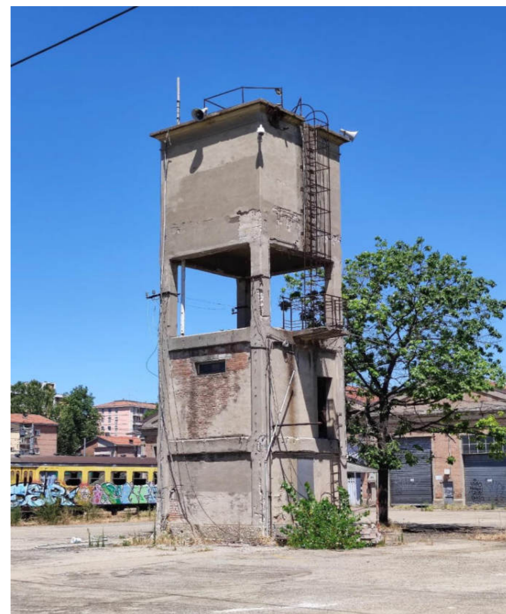
10 – Torre piezometrica, foglio 175, part. 201
