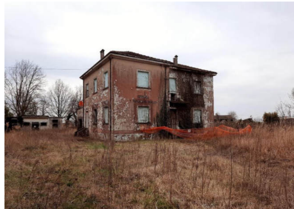
Figura 15. Foto Fonte: Regione Emilia-Romagna - sopralluogo 2022
