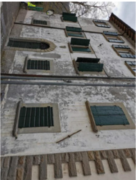
Figura 11. Foto Fonte: Regione Emilia-Romagna sopralluogo 2021
