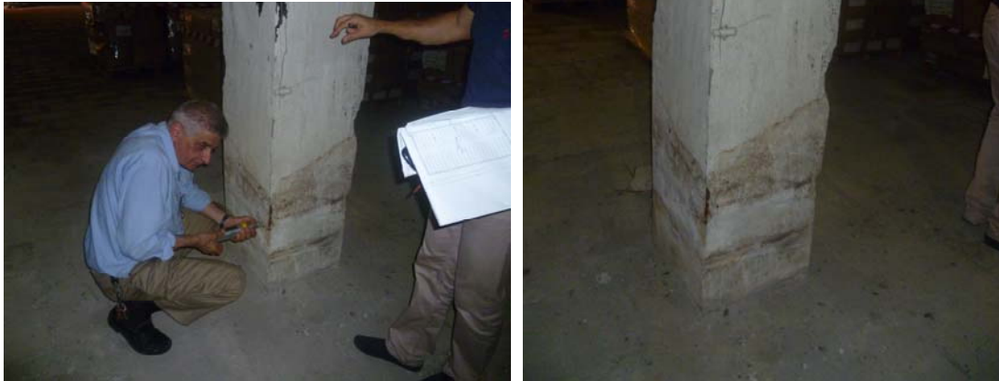
Mancanza di copriferro in alcuni punti dei pilastri in c.a.
