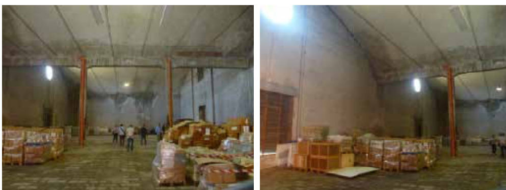
Calcestruzzi ammalorati causa percolazione e infiltrazione acqua
