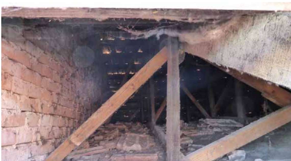
Figura 29: Intercapedine fra il solaio voltato e la copertura in legno, si nota la precarietà della struttura lignea che sostiene il manto in tegole marsigliesi.
