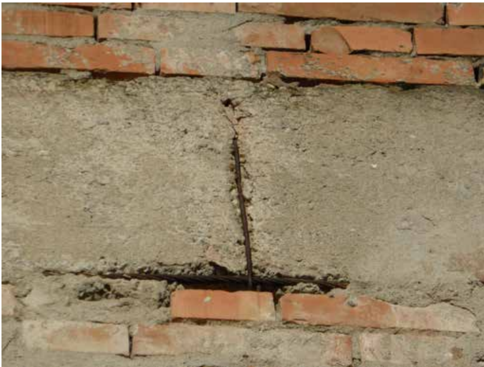
Figura 17: Particolare di degrado del copriferro sul cordolo del fronte est.
