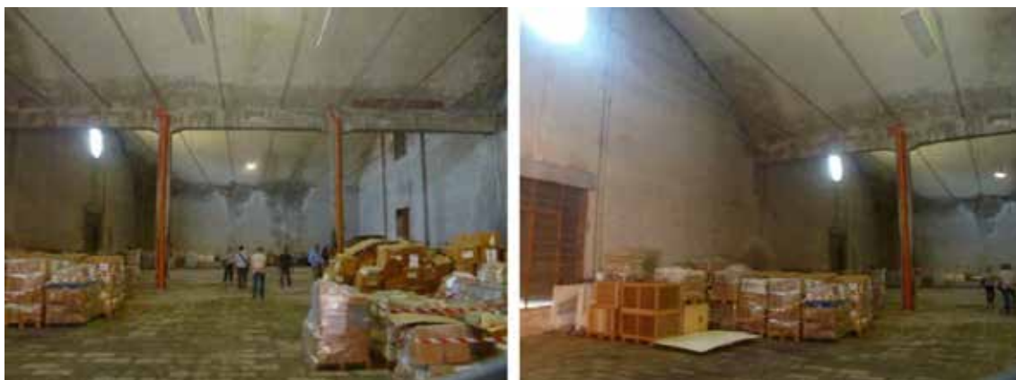
Figura 4: Sala Schellenberg, vista dall'interno con catene a contrasto della spinta dei solai voltati.
