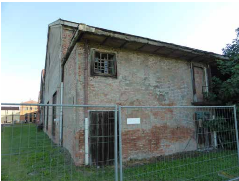
Figura 12: Superfeticazioni da demolire sul fronte sud del fabbricato.
