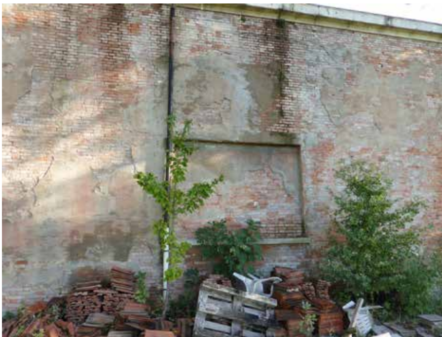
Figura 14: Fessurazioni murarie verticali e sintomi di degrado delle murature sul fronte sud.
