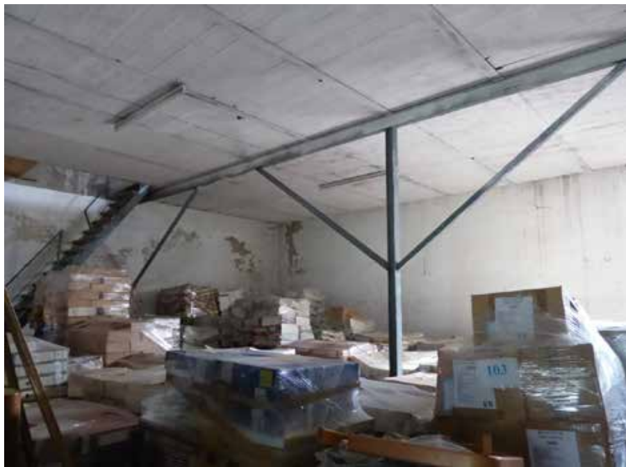
Figura 31: Corpo nord-ovest, solaio intermedio in putrelle HEA100 e tavelloni, sostenuto da telai interni in profilati metallici, poco efficienti ai fini sismici.
