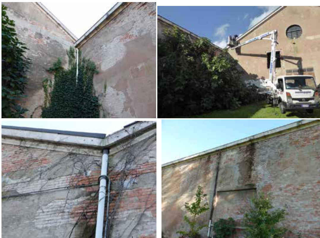
Figura 11: Vegetazione rampicante e arbustiva attecchita sulle pareti esterne.
