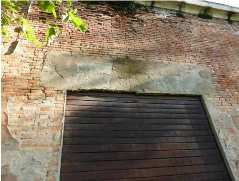
Figura 13: Architrave esistente in c.a. con porzione di muratura sotto il cornicione con vegetazione e mattoni degradati.
