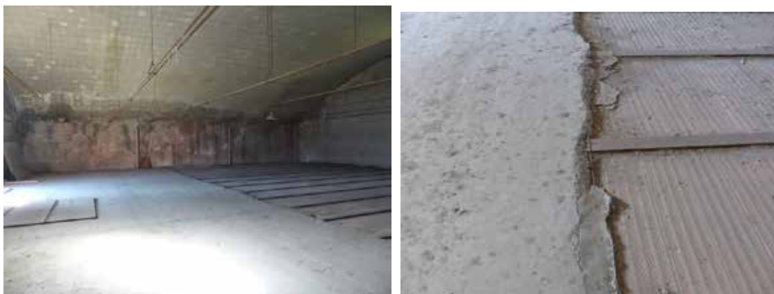
Figura 32: Solaio intermedio del corpo di nord-ovest, si nota la presenza di una cappa in c.a. con rete elettrosaldata soltanto su metà della superficie dell’impalcato.
