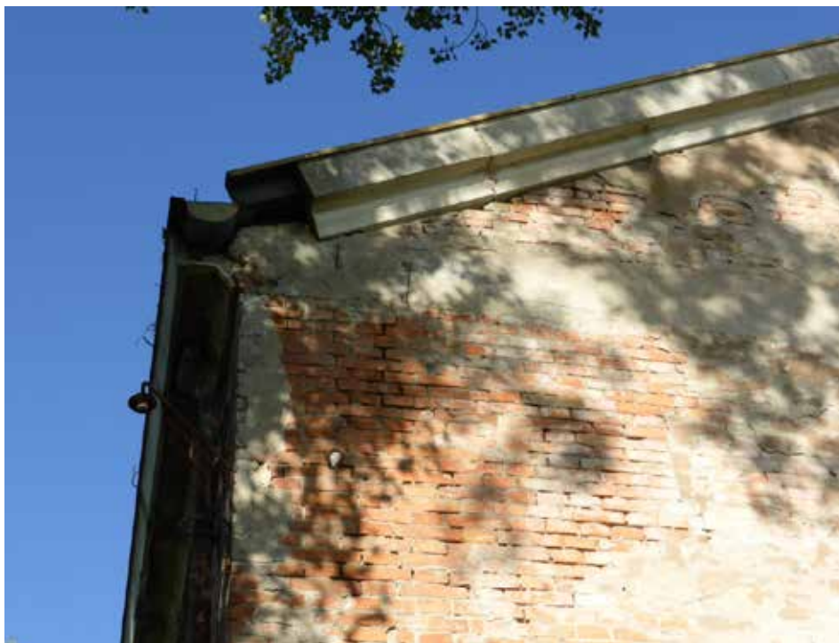
Figura 15: Fessurazioni in corrispondenza del cantonale di sud-est.
