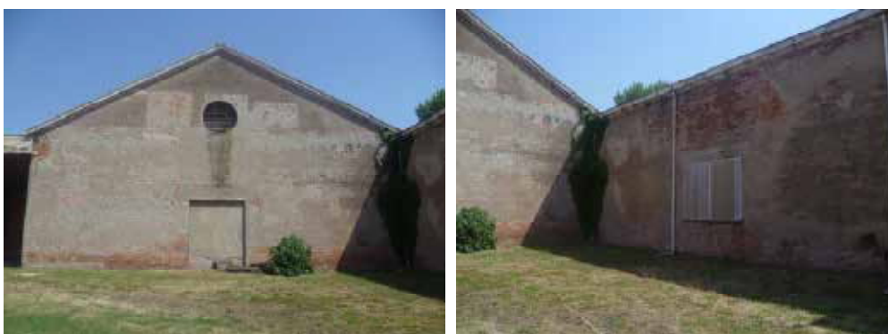
Mancanza e distacco di intonaco nelle facciate
