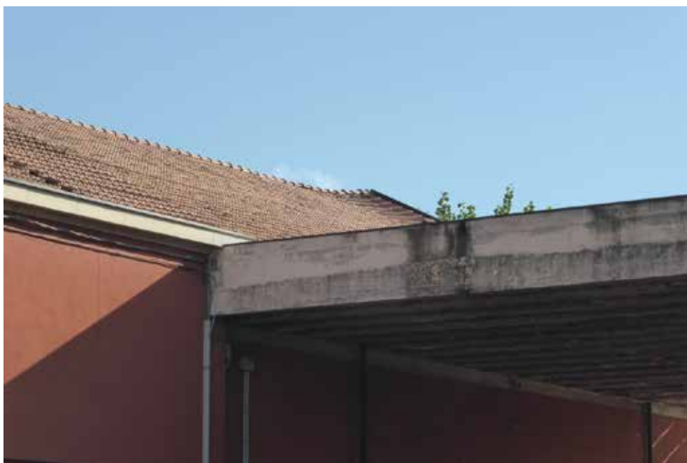
Figura 27: Avvallamenti nel manto di copertura.
