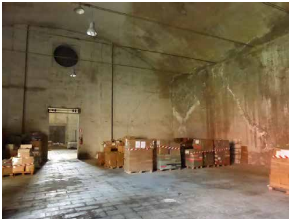
Figura 23: Interno della sala Brenneke (corpo centrale), si nota l'ammaloramento delle murature esterne per presenza di umidità ascendente e discendente, la lesione presumibilmente indotta da cedimento fondale della parete divisoria dal lato della sala Schellenberg ed il distacco in testa della volta dalla stessa parete.
