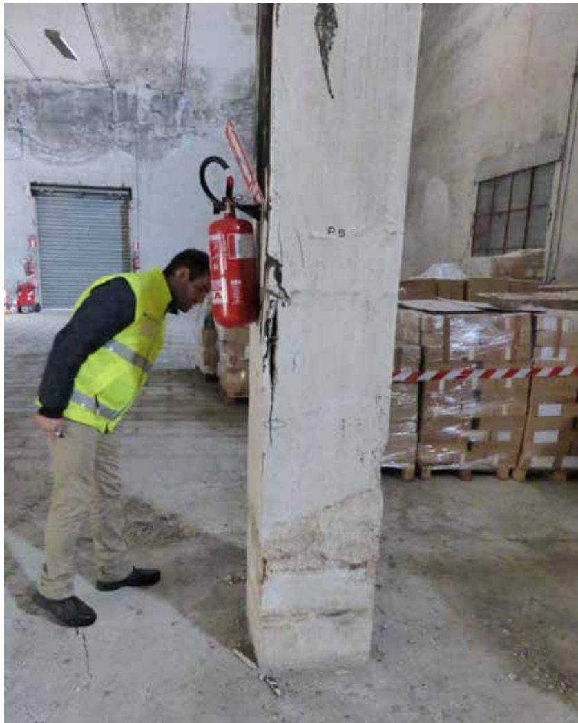
Figura 25: Pilastro in c.a. nella sala Schellenberg con copriferro degradato.
