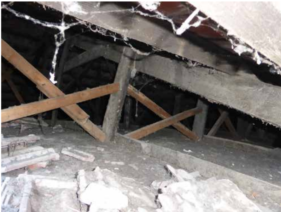
Figura 30: Copertura lignea, particolare delle tavole di irrigidimento in direzione longitudinale e trasversale.
