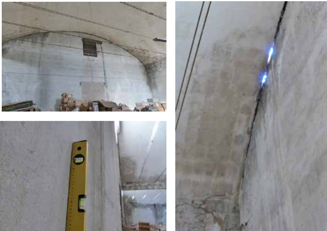
Figura 26: Distacchi fra le volte interne in latero-cemento e le pareti perimetrali esterne, con leggerissimo fuori piombo delle stesse verso l'esterno.
