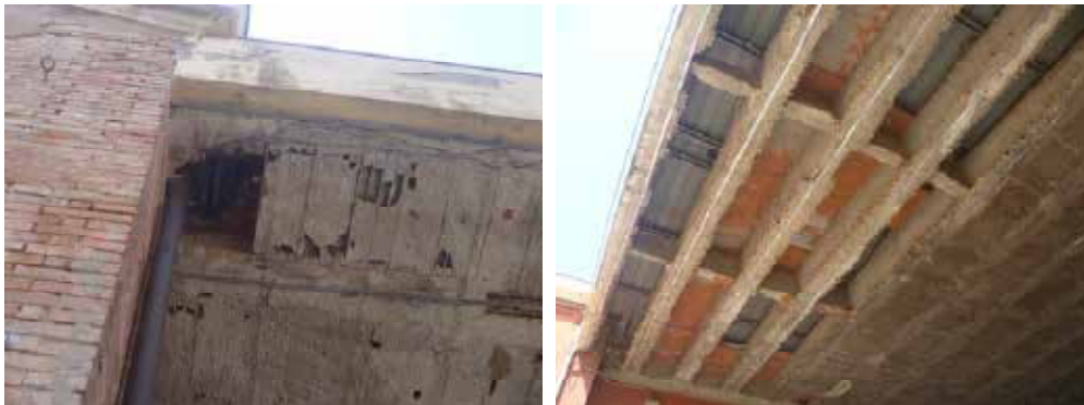
Ammaloramento diffuso nei solai di collegamento tra i corpi
