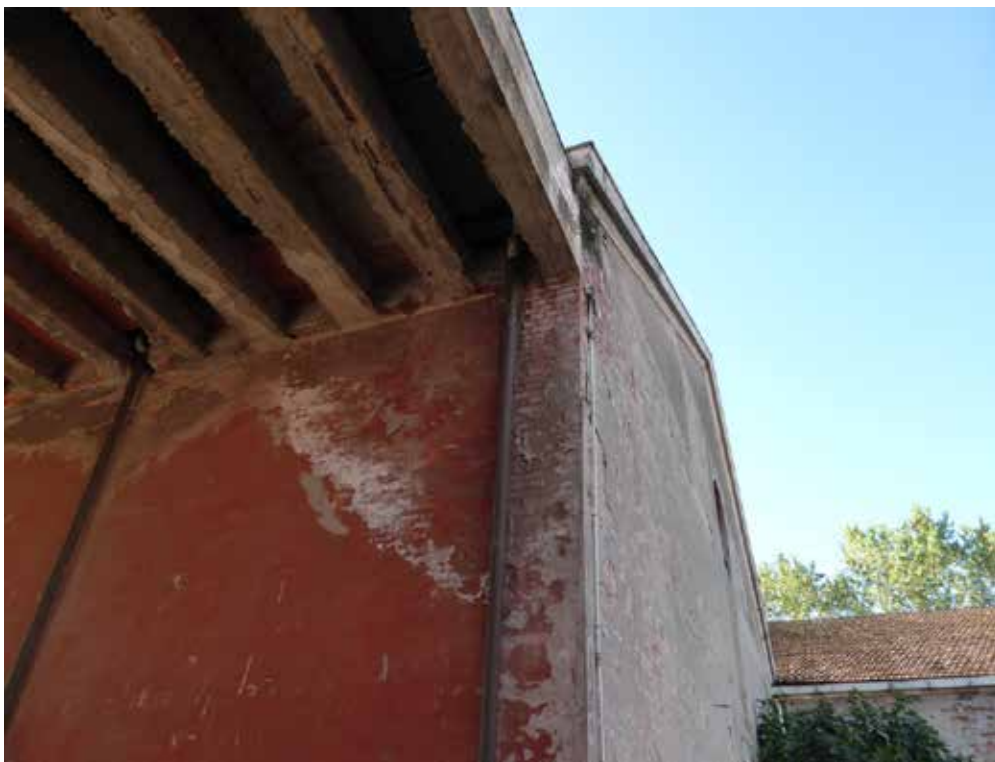
Figura 19: Pensiline esterne di collegamento con la porzione nord, con demolizione da completare.
