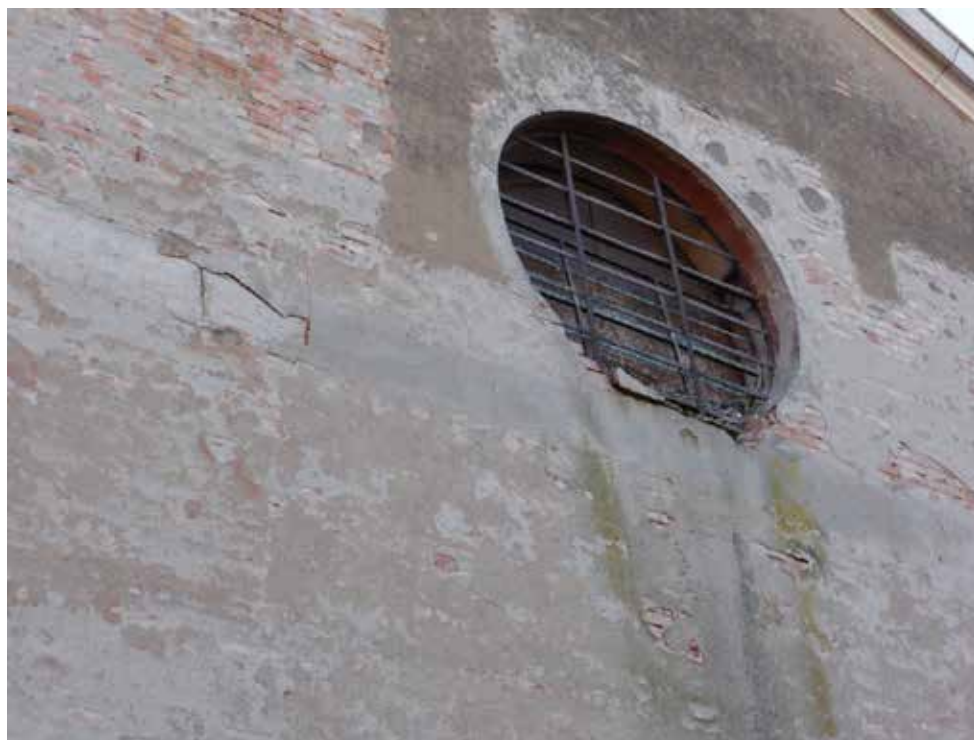
Figura 20: Degrado su un rosone che affaccia sul cortile interno.
