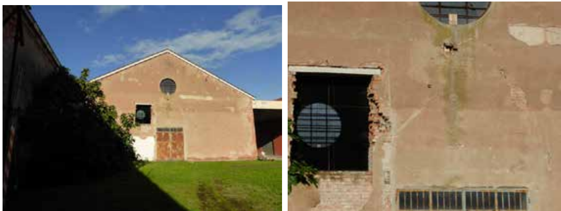
Figura 22: Prospetto sulla corte interna della porzione di nord-ovest, con indebolimento della muratura indotto da un'apertura in posizione sfavorevole, che (dettaglio a destra) ha agevolato la formazione di fessurazioni in corrispondenza della fascia di piano.
