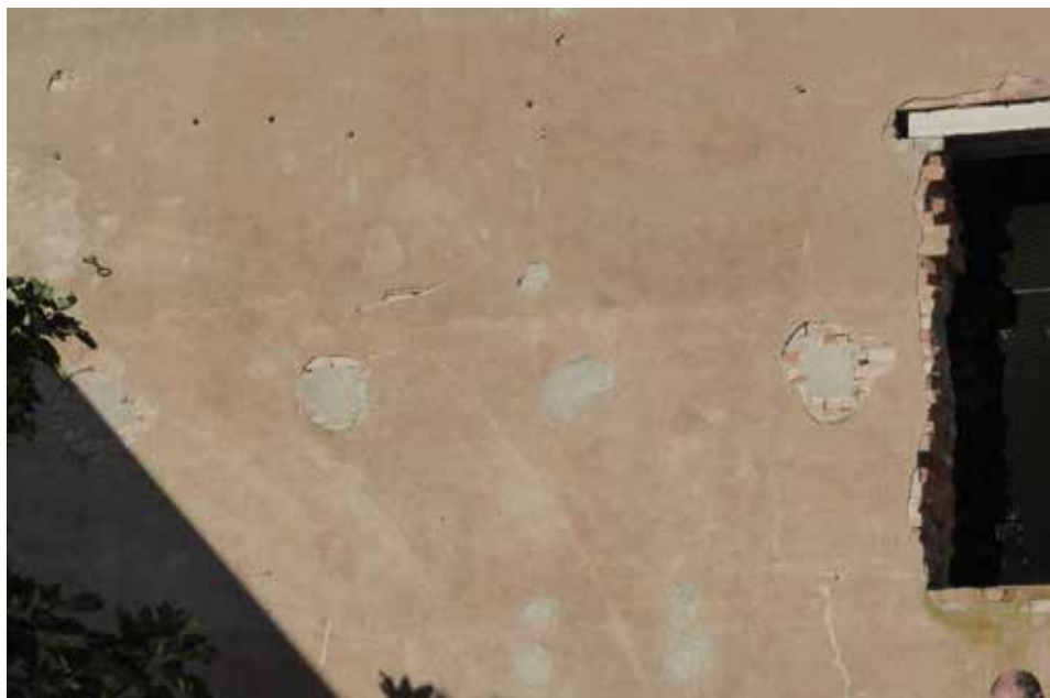
Figura 28: Porzione di nord-ovest, tracce indicanti gli innesti delle travi metalliche del solaio intermedio posticcio.
