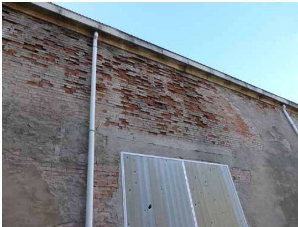
Figura 21: Degrado dei laterizi sul paramento murario esterno, lato corte.
