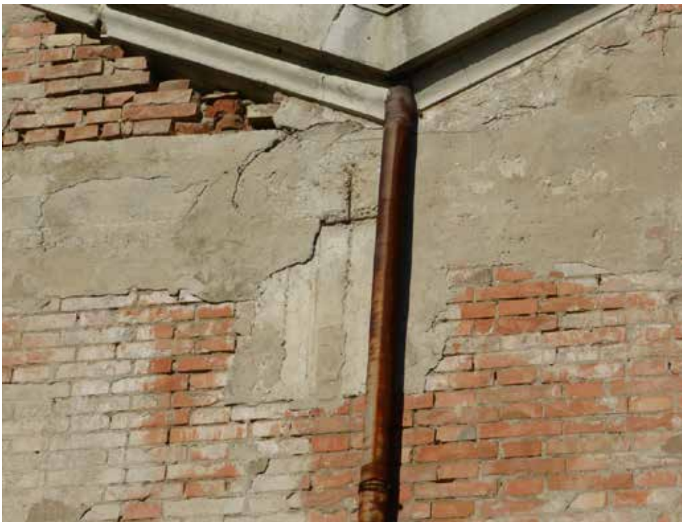
Figura 18: Dettaglio dell'innesto della trave del telaio in c.a. interno nella muratura perimetrale.
