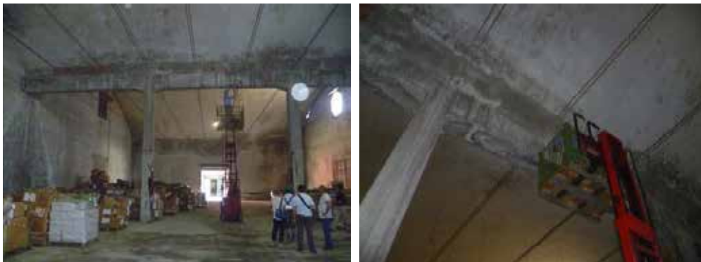
Calcestruzzi ammalorati causa percolazione e infiltrazione acqua
