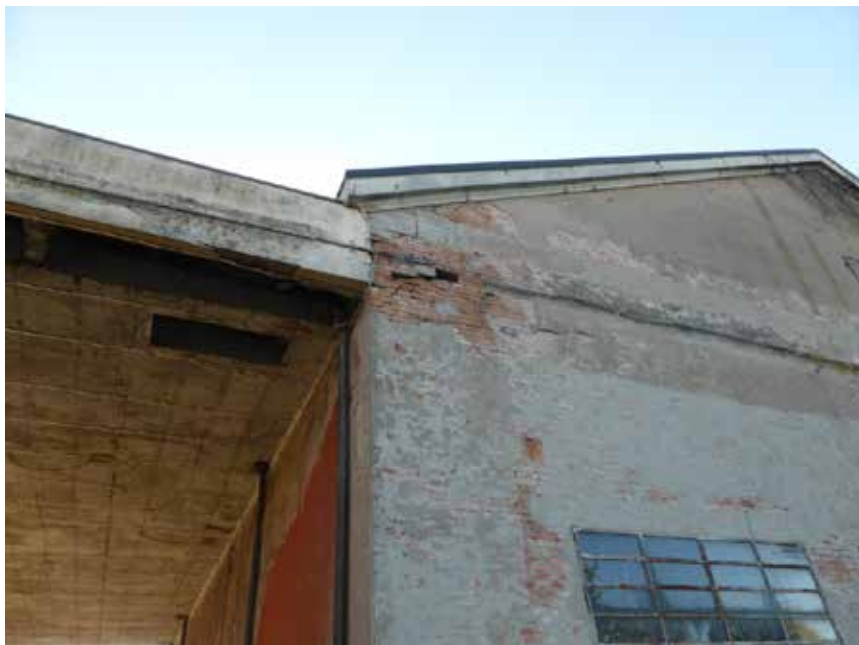
Figura 10: Dettaglio delle lesioni ai cantonali lato nord presumibilmente indotte dai lavori di demolizione.
