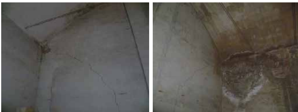
Lesione diagonale nella parete interna parallela alla volta
