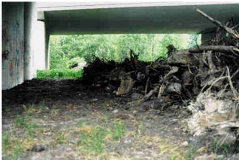
Figura. Esempio di sottopasso per fauna di grandi dimensioni (da Infra Eco Network Europe).
