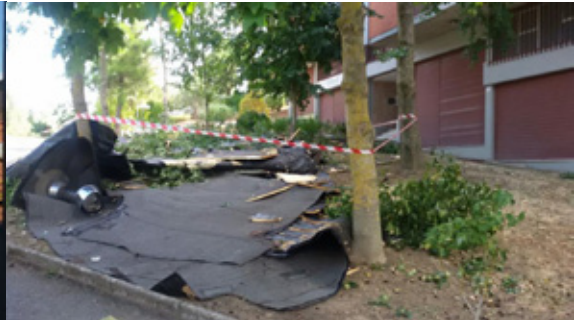
Castrocaro - Copertura divelta (Da Servizio Area Romagna)
