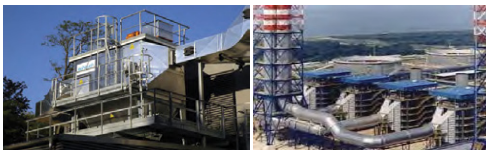
Figura 76: precipitatore elettrostatico di un sistema di riscaldamento a biomassa con potenza di 2 MW (a sinistra - fonte wikipedia), centrale di cogenerazione di Imola (a destra).
