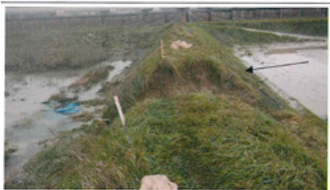
Figura 13: Danni all'argine in località la Barchetta (Campogalliano)
